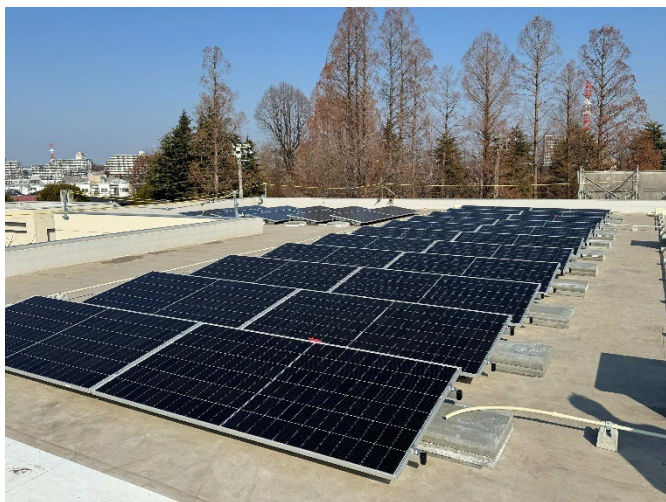
市内小学校の太陽光発電設備
